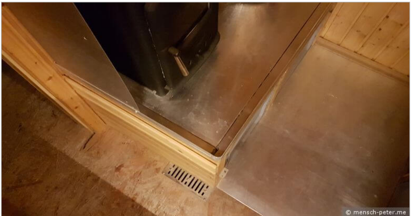
Holzofen Willow - Frischluftzufuhr (Bild 1/1)
